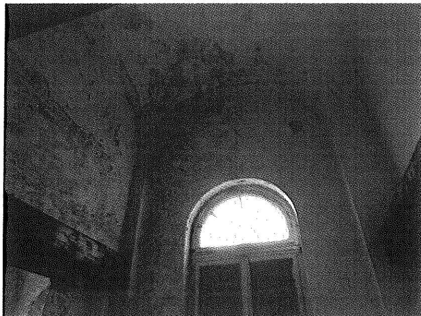
Obr. 7: Stopy po zatékání na vnitřní omítce
