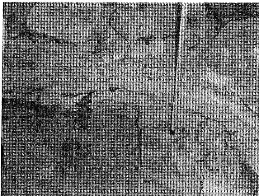
Obr. 3: Sonda do skladby podlahy - nefunkční vodorovná hydroizolace
