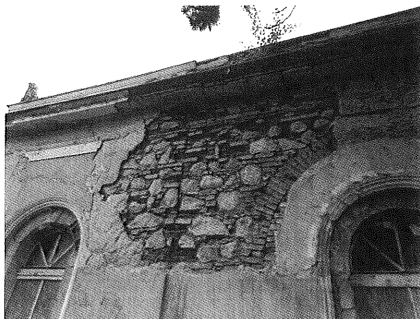
Obr. 6: Narušené, neprovázané zdivo, zatékání z okapu
